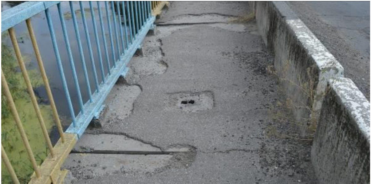
Рисунок 3 – Руйнування асфальтобетонного покриття на тротуарах
