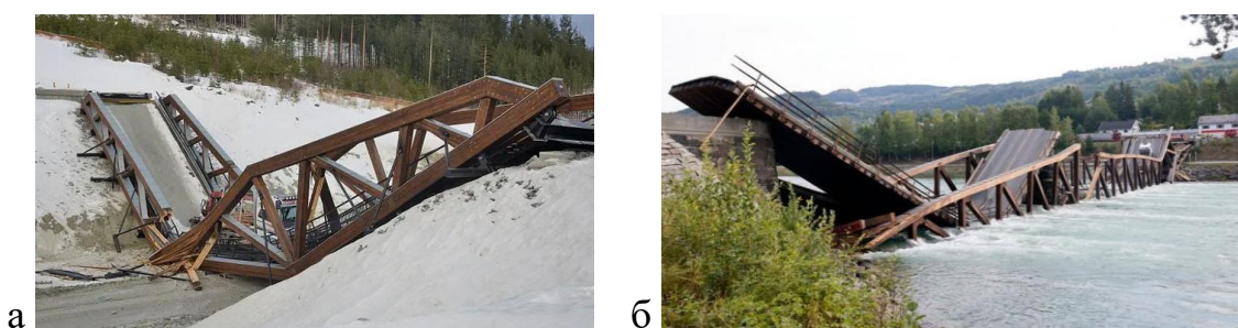
Рис. 1.8 – Зруйнований дерев'яний шляхопровід (а) та міст (б) [2]
