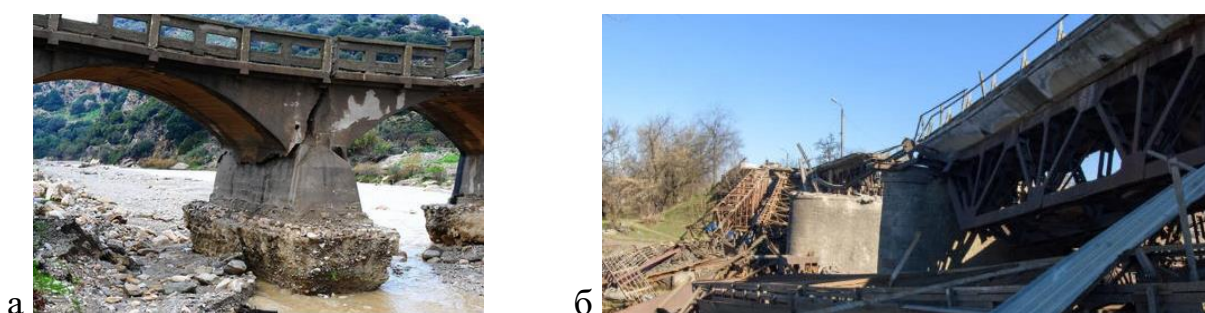
Рисунок 1 – Руйнування опори: а – кам'яної; б – бетонної [2]
