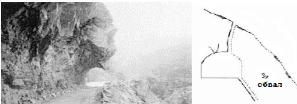
Рисунок 2 – Руйнування тунельної оправи внаслідок обвалу укосу
