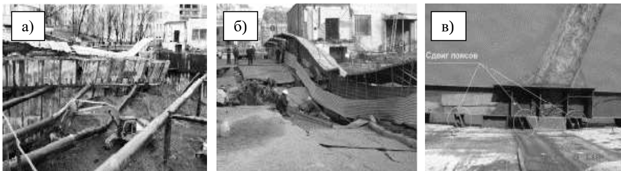
а) руйнування розпірної системи та «стіни в ґрунті»; б) провал на проїзній частині поруч з аварійною ділянкою; в) поздовжній зсув обв'язувальних поясів вздовж «стіни в ґрунті»
