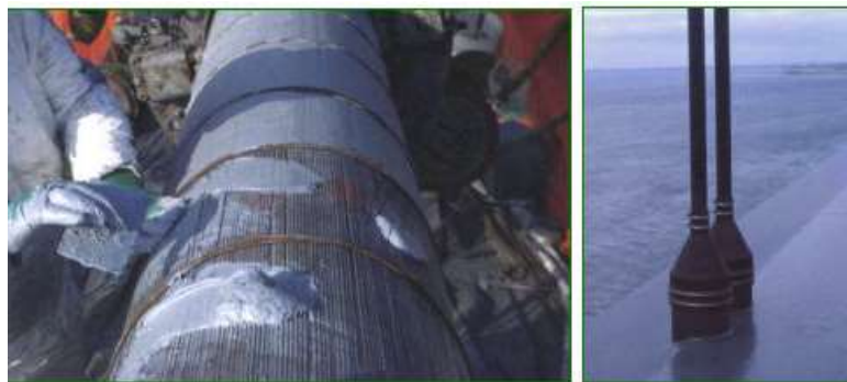
Рисунок 1 – Антикорозійний захист канатних елементів мосту Сторебелт
