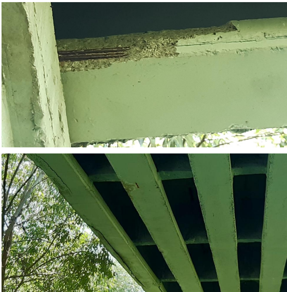
Рисунок 5 – Пошкодження балок прогонових будов
