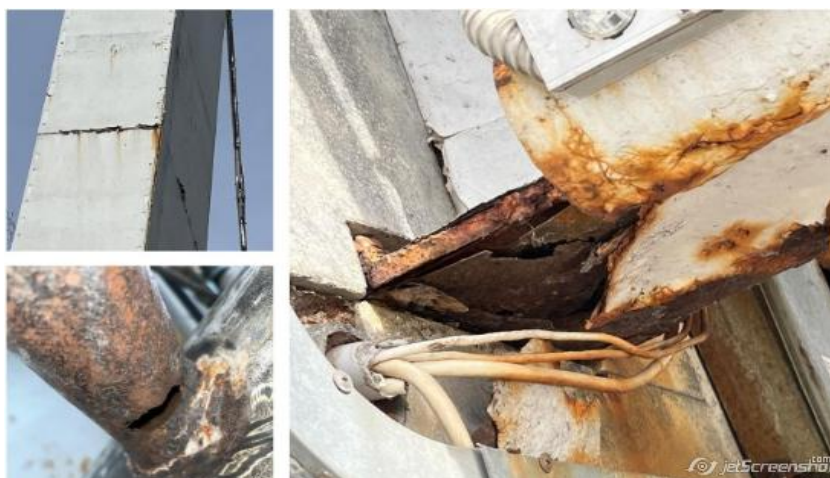
Рисунок 9 – Дефекти мосту (2023 р.)
