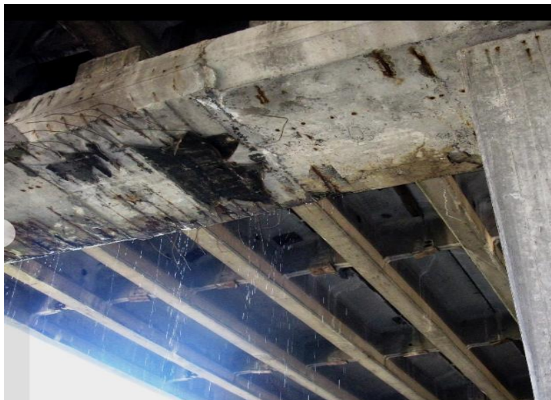
Рисунок 7 – Протікання води через конструкцію мосту продовжується і після реконструкції мостового полотна (Комплекс споруд на проспекті Льва Ландау)
