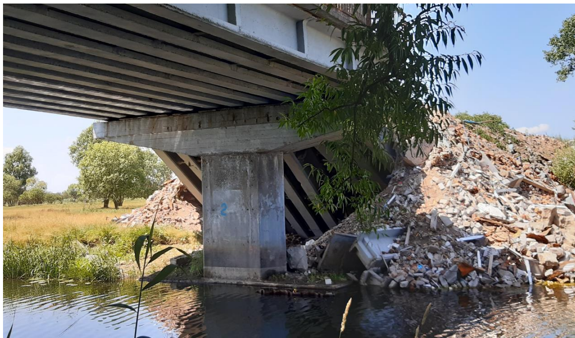
Рисунок 4 – Вид на опору №6 та зруйновані прольоти
