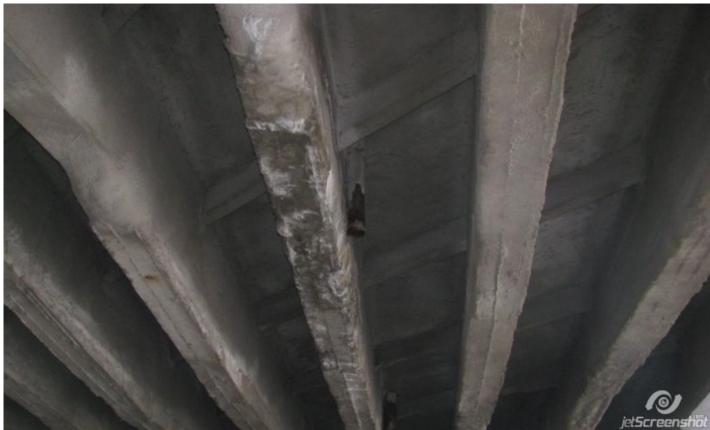
Рисунок 6 – Нетеченський міст в 2011р: дефект реконструкції у вигляді порушення проєктних вимог з водовідводу та з товщини плити на мосту
