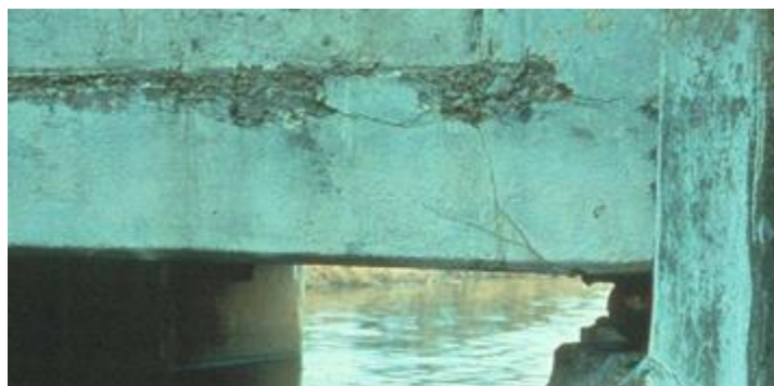
Рисунок 2 – Тріщина зсуву на балці плити
