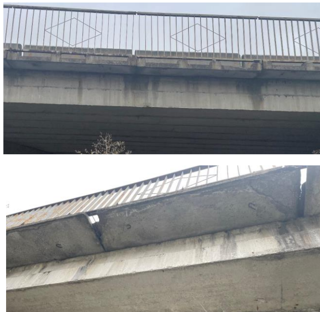
Рисунок 4 – Дефекти тротуарних блоків
