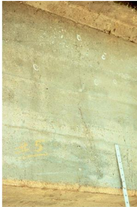
Рисунок 1 – Згинальна тріщина на тавровій балці
