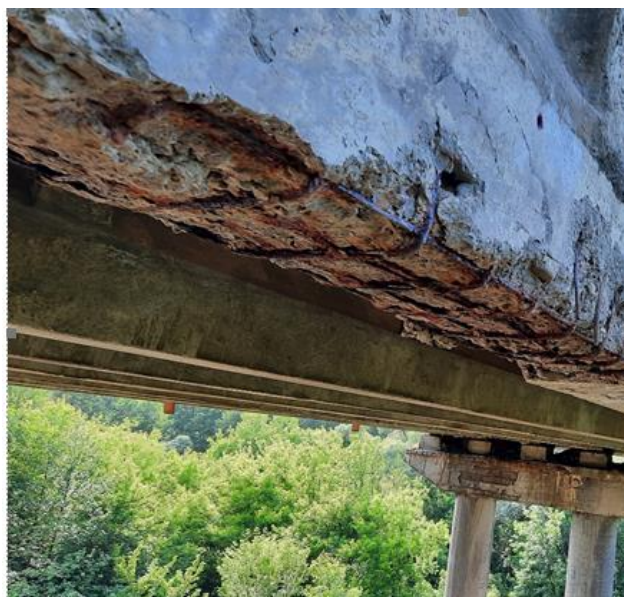
Рисунок 4 – Оголена кородована арматура залізобетонного елемента
