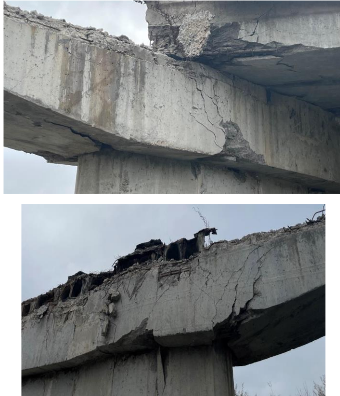
Рисунок 3 – Дефекти опор мосту
