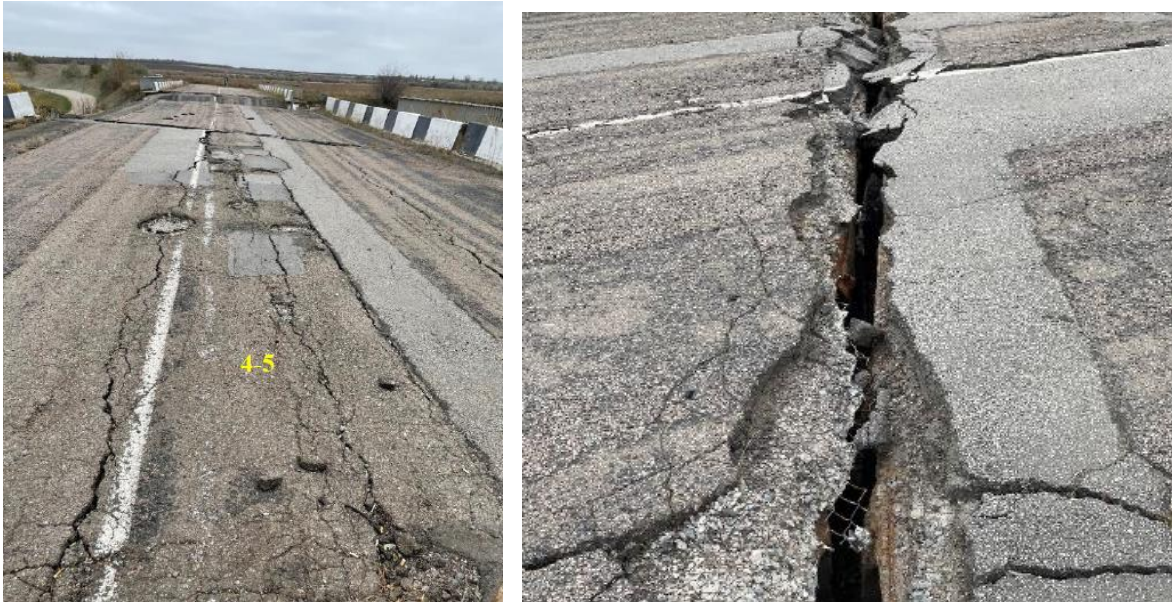
Рисунок 5 – Дефекти мостового полотна
