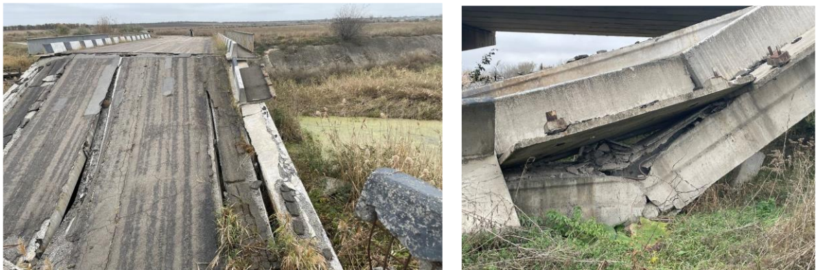
Рисунок 2 – Дефекти прогонових будов мосту
