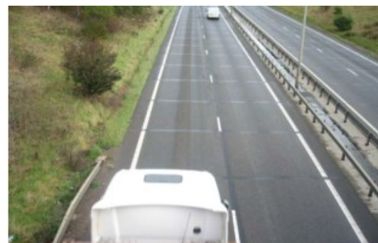
Відображені тріщини над стиками плит
