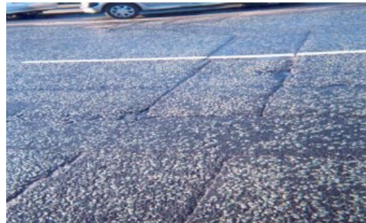
Тріщини після локального ремонту
