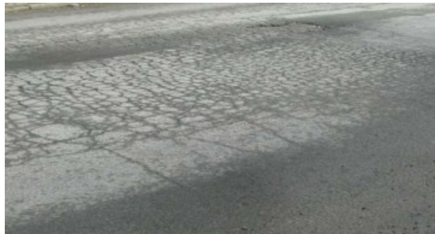
Сітки тріщин «алігаторова шкіра»
