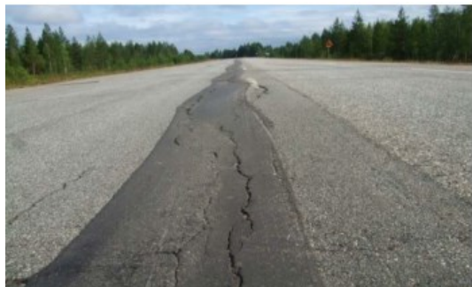
Температурні та втомні тріщини
