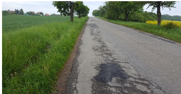
Тріщини, викликані дефектами основи
