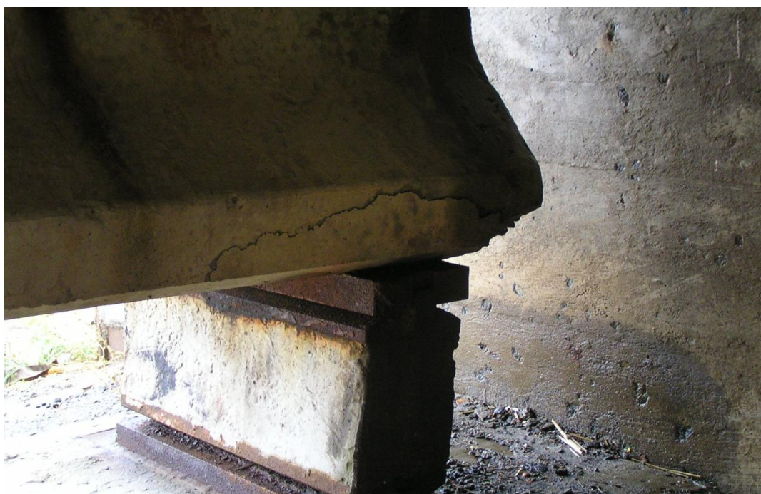
Рисунок 3 – Руйнування балки при поганій роботі опорної частини
