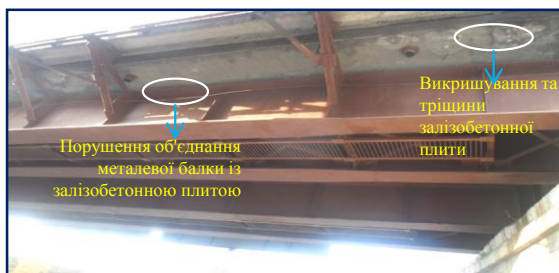
Рис. 1. Характерні пошкодження сталезалізобетонних мостів у процесі експлуатації
