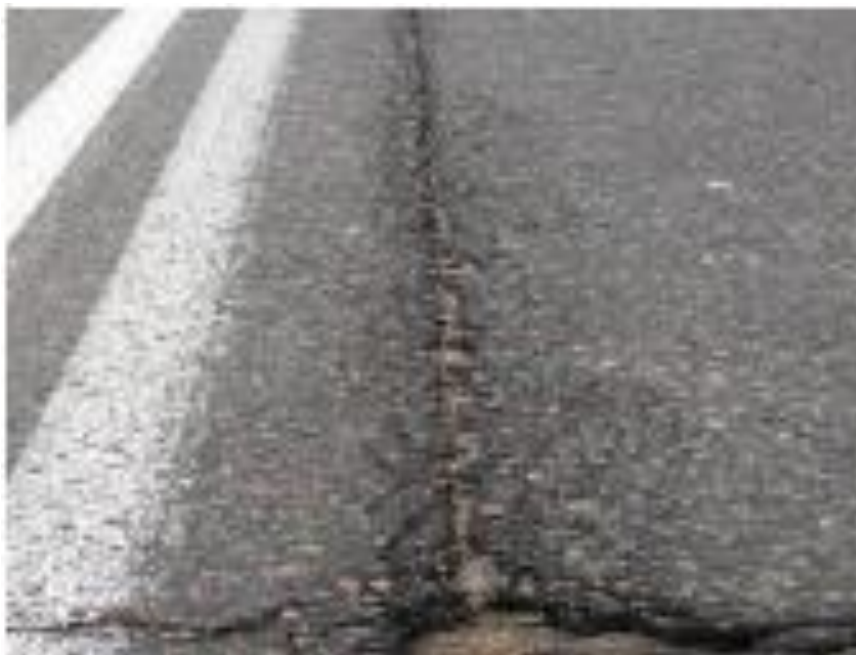
Рисунок 3 – Руйнування покриття в зоні технологічної тріщини
