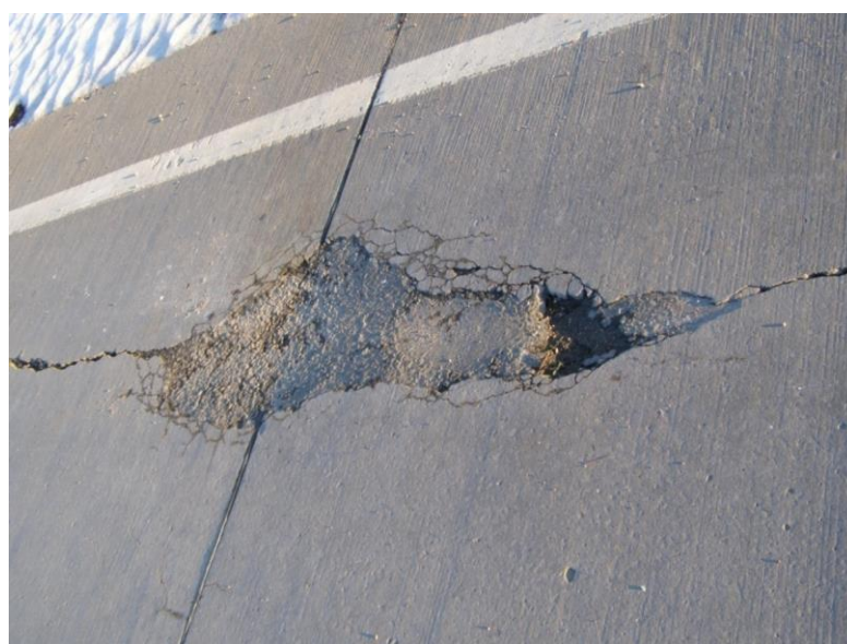
Рисунок 4 – Подальше руйнування відремонтованих вибоїн
