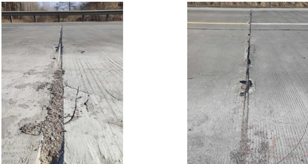
Рисунок 5 – Зруйновані кромки цементобетонних плит
