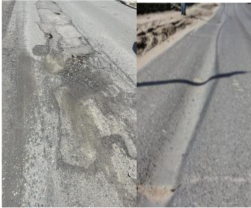
Рисунок 2 – Деформації та руйнування дорожнього покриття
