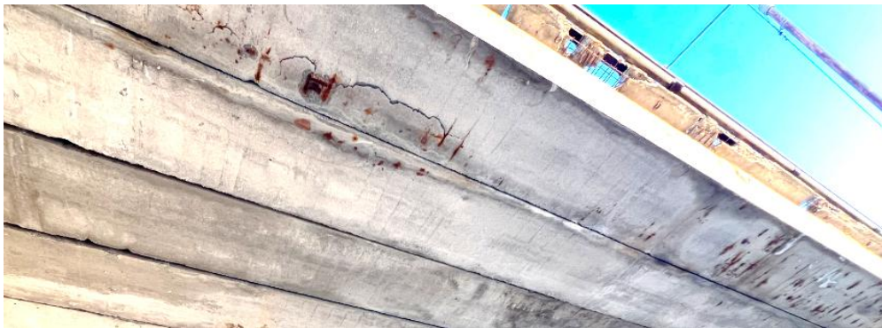
Рис. 1. Сліди затікання води крізь шви між плитними балками та з краю прогону шляхопроводу на автодорозі М-05 Київ – Одеса, вилугування бетону, особливо вздовж швів
