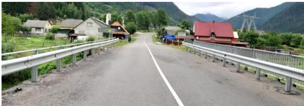
Рис. 3. Мостове полотно мосту через р. Голятинка на Закарпатті. Відсутній борт між тротуаром та проїзною частиною
