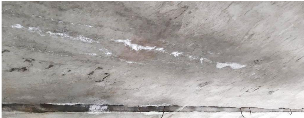
Рис. 2. Міст на автодорозі Т-07-24 Синевир – Синевирська Поляна через р. Теремля. Просочування води крізь плитну балку вздовж робочої арматури. Висоли, поверхня замочена
