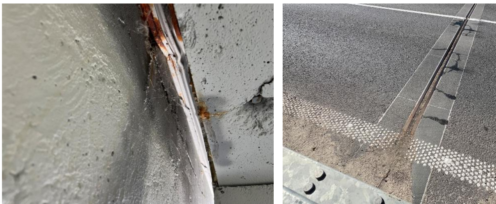
Рис. 4. Дефект деформаційного шва нового мосту через р. Тростяниця на автодорозі М-21 на Житомирщині. Вода затікає на шафову стінку та торці балок
